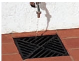
Punktavlopp med spaltgaller i segjärn.
